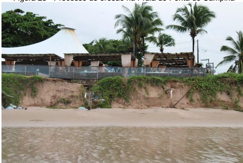
Figura 23 - Processo de erosão na Praia de Ponta de Campina
